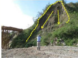
Fotografía 13. Panorámica del sector inestable de mayores dimensiones.
