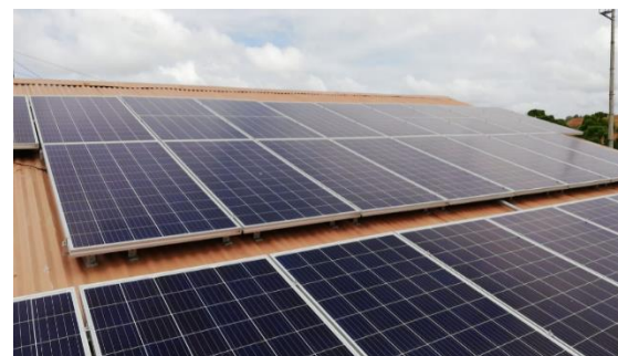
Ilustración 20 Sistema de generación de energía eléctrica
