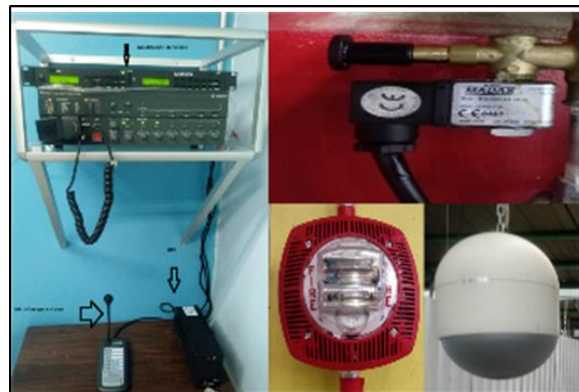
Ilustración 25. Sistema de seguridad ante incendios
