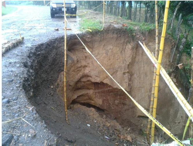
Colapso de estructura de retención y pérdida de superficie de ruedo del camino.
