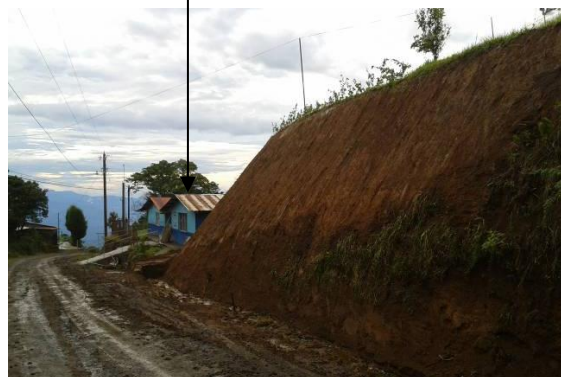
Retiro de material deslizado y conformación de taludes para protección y reducción de riesgo a la infraestructura de la Escuela
