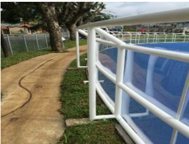
Barandas y lamina policarbonato resiste a golpes (233m)
