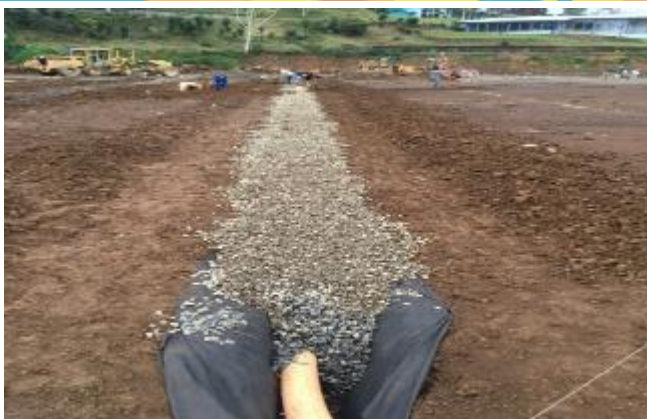
Sistema drenajes (más de 1500m)
