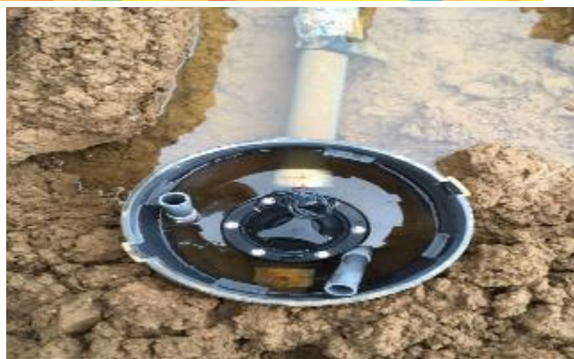
Sistema de riego, Tuberías de distribución (500m),
