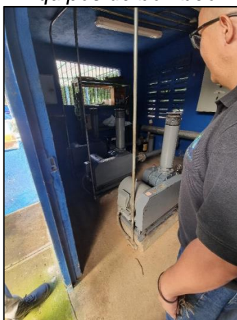
IMAGEN N° 3: Equipos de bombeo.
