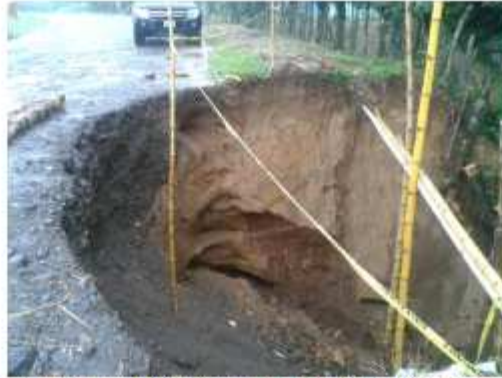
Colapso de estructura de retención y pérdida de superficie de ruedo del camino.
