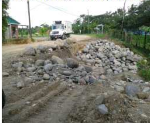
Se reduce el riesgo de mayor deslizamiento, brindando un paso más seguro a los usuarios de la vía
