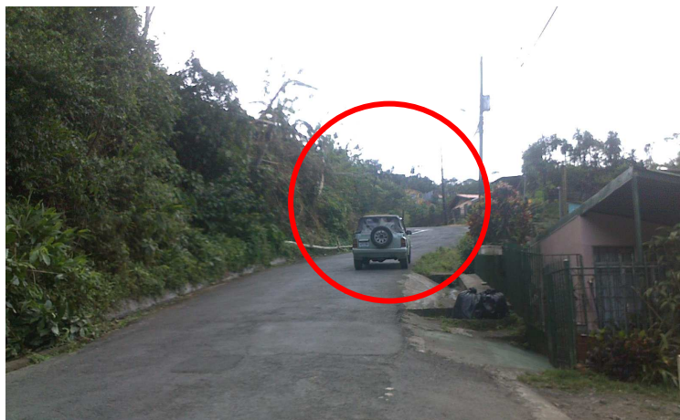
Fotografía 1 Punto por el cual discurre el agua que aporta el corte de alcantarilla anómalo que puede provocar un problema de estabilidad en el talud.
