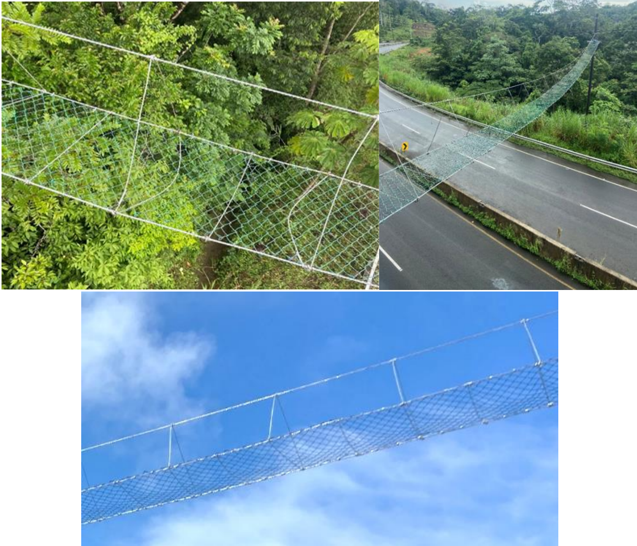
Figura 118. Ejemplo de pasos aéreos, paso triangular con base de malla, carretera ruta 35, sección Florencia-La Abundancia y ruta1, sección Cañas-Limonal
