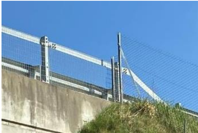
Figura 122. Detalle de ejemplo de la continuidad del mallado inmediatamente después de la baranda del puente.
