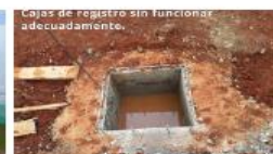
Cajas de registro sin funcionar adecuadamente.
