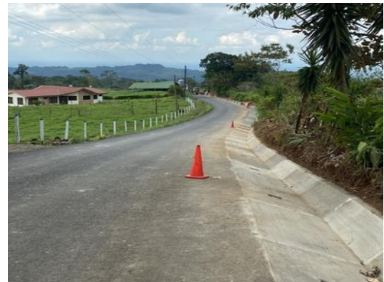
Cunetas para mitigar la erosión en margen del cauce, río Aguas Zarcas Fuente: Comisión Municipal de Emergencias
